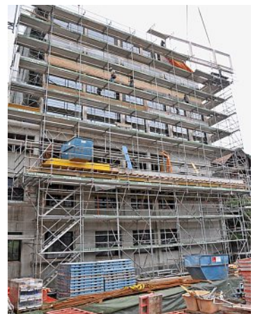
Vor allem von der Zelgstrasse her sind die Dimensionen des Gebäudes gut erkennbar. Fotos: nik
